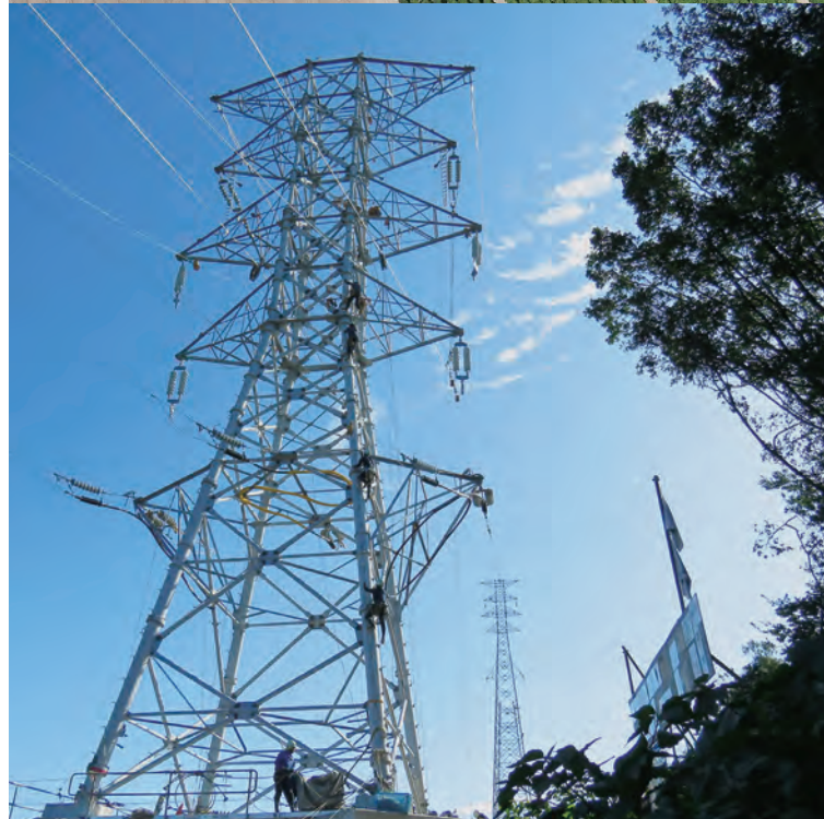
■ウィンドファームつがる[グリーンパワーインベストメント] (写真上) 電力設備
