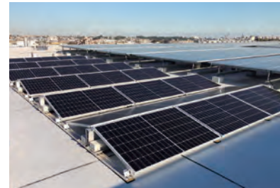
■セムリンクス川崎テクニカルセンター 太陽光発電設備 神奈川県 SEMLINKS Kawasaki Technical Center Photovoltaic Power Generating System Kanagawa Pref.
