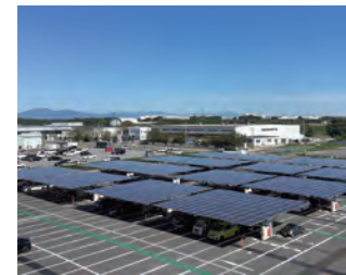
■ホンダテクノフォート第2駐車場 太陽光発電設備 栃木県 The Second Parking Lot, Honda Techno Fort Co., Ltd. Photovoltaic Power Generating System Tochigi Pref.
