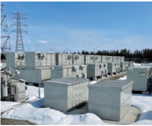
■北海道電力ネットワーク 南早来変電所 電気設備(レドックスフロー電池) 北海道 Minamihayakita Substation, Hokkaido Electric Power Network, Inc. Electrical System(Redox Flow Battery) Hokkaido Pref.
