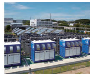
■住友電工 横浜製作所 大規模蓄電システム プラント設備 神奈川県 Power Generation/Storage System, Yokohama Works, Sumitomo Electric Industries, Ltd. Plant System Kanagawa Pref.
