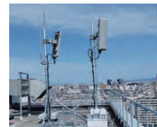
■無線基地局(1) 通信設備
