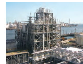
■食品加工油 製造プラント プラント設備 Edible Oil Plant Plant System
